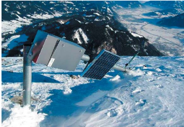
Bruch des 100 mm starken Stahlrohres, aufgenommen am 21.12.2007. Foto: LWD
