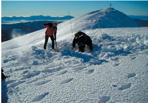
Die Suche nach dem bereits betonierten Fundament unter den Schneemassen gestaltete sich schwierig. Foto: LWD
