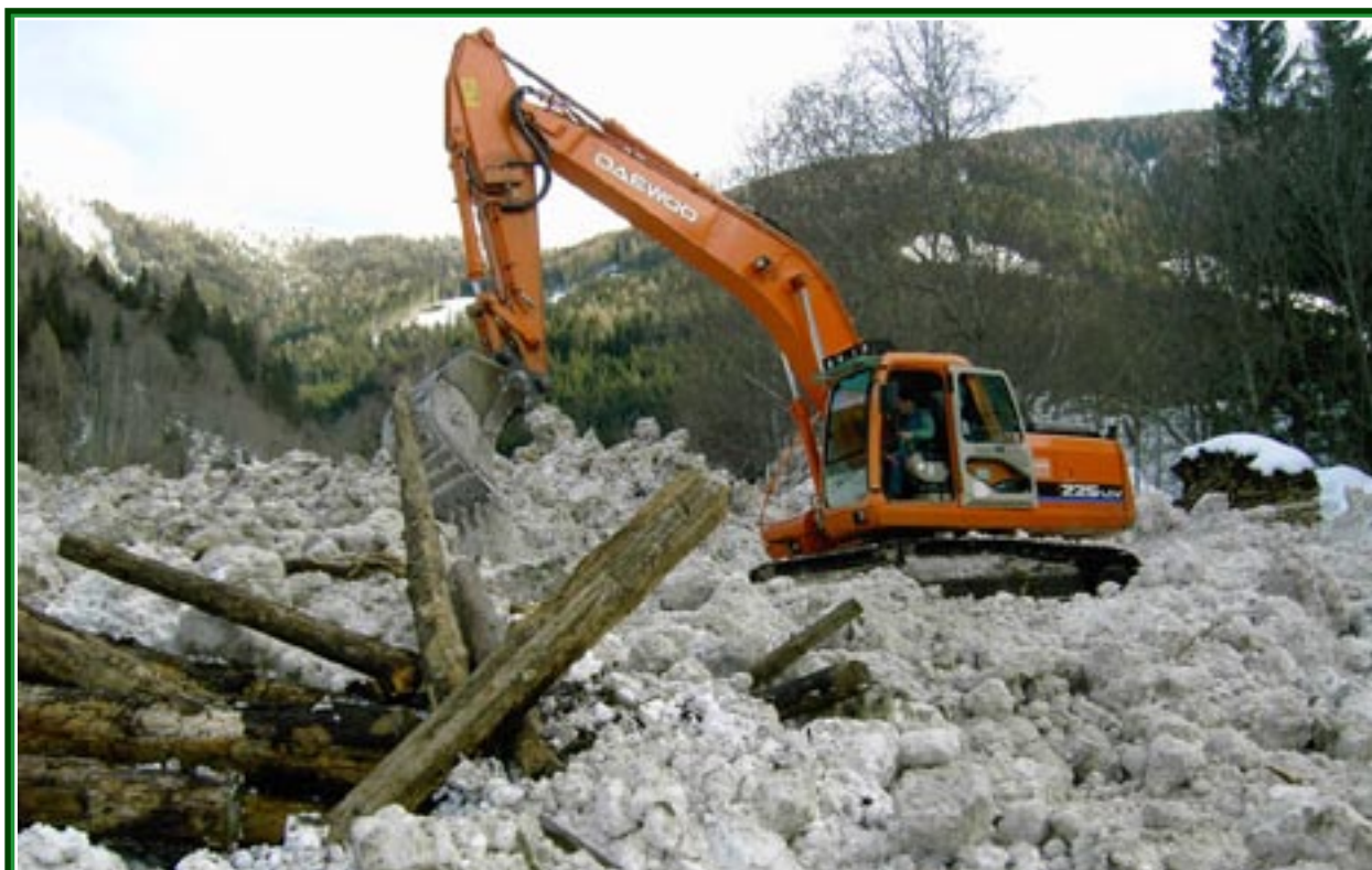
Aufräumarbeiten in Kleinsölk: Am 28.02.2009 löste sich hier die Bröckelgrabenlawine und drang bis ins bewohnte Gebiet vor. Foto: Gemeinde Kleinsölk
