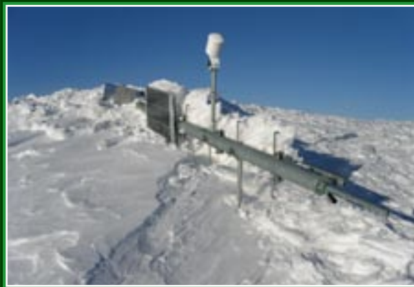
Die meteorologische Messstation auf der Hohen Veitsch erlitt einen Mastbruch, aufgenommen am 30.12.2008. Foto: LWD
