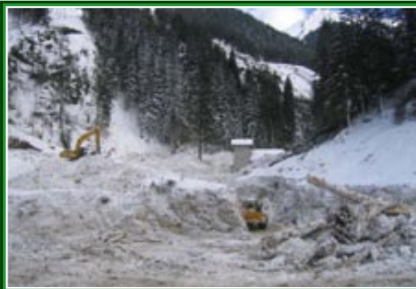
Verschüttetes Kleinkraftwerk und Räumungsarbeiten der Planneralmstraße. Foto: LK Planneralm
